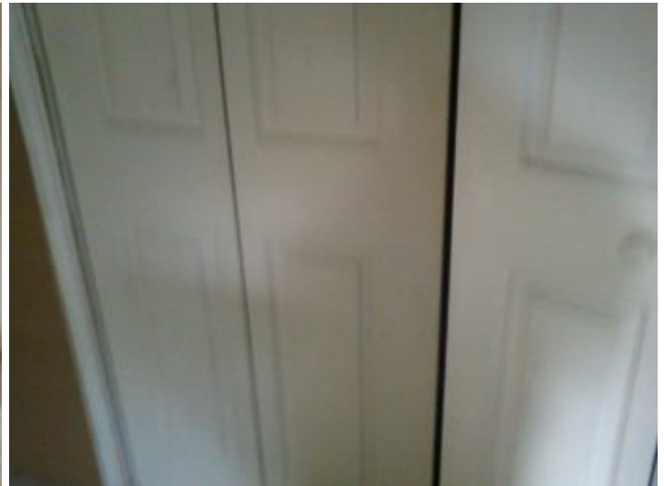
Missing door handles
