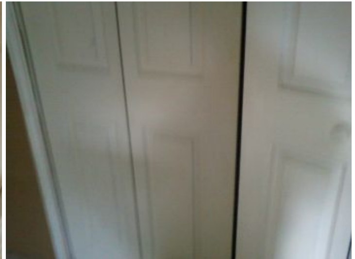
Missing door handles
